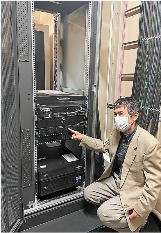
新たに導入したディープラーニングシステムを説明する田中敦副センター長 ＝米沢市・山形大工学部
